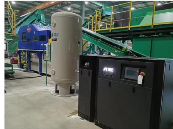
付帯設備(コンプレッサー)
