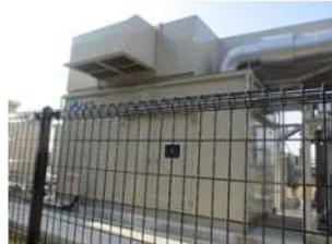
ガスエンジン 1,000kw×1基 発電効率38.9%
