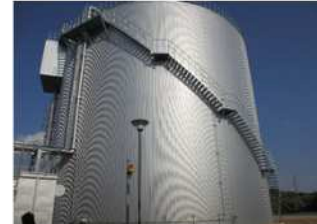
湿式中温発酵槽(鋼板製) 5,000m 3 ×2基
