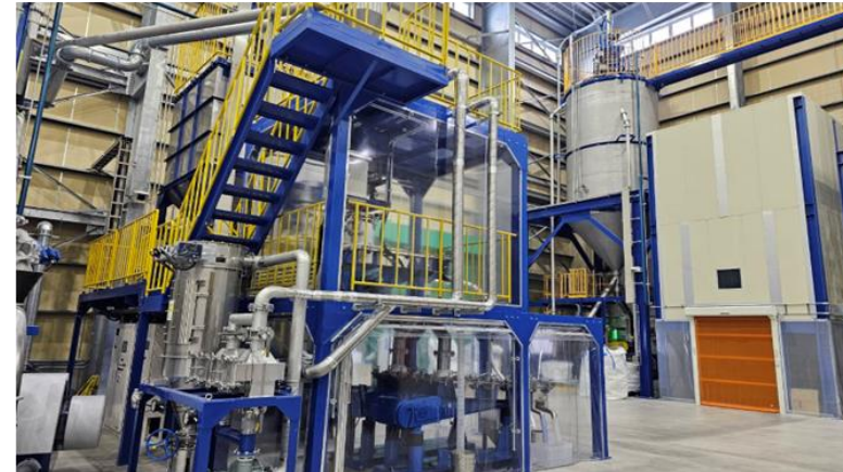
ペレット輸送設備
